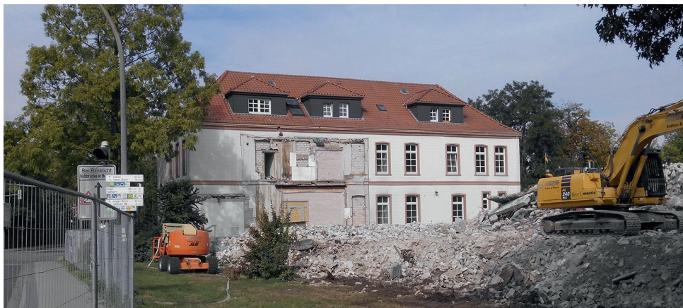
Der Flachdachanbau musste abgerissen werden (Foto: Robert Fitzner, Meppen)
