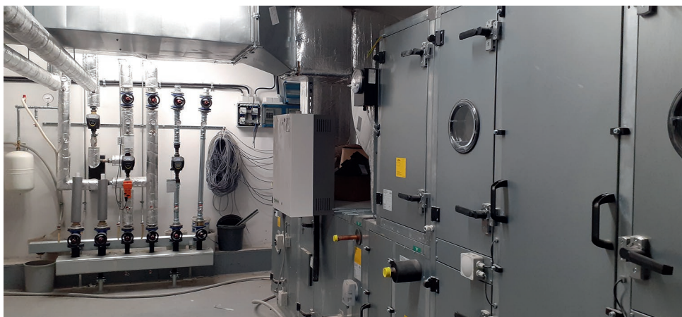
Der Magazinkeller des Kreisarchivs verfügt über eine eigenständig gesteuerte Be- und Entlüftungsanlage (Foto: Kreisarchiv Emsland)
